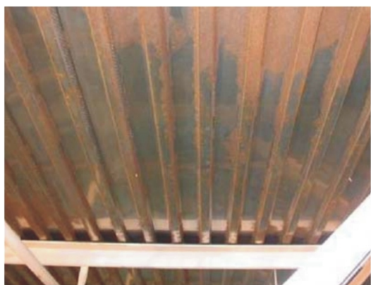
图12 室内游泳池上方屋顶304不锈钢的腐蚀状况。 供图/TMR咨询公司
