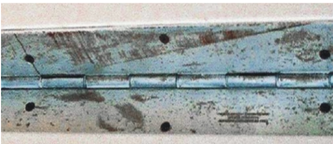
图5 一家清洗承包商使用碳钢刷清洗安装在室内游泳池旁边不锈钢门的合页。被碳钢污染的区域已生锈。 供图/TMR咨询公司
