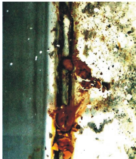
图6 在一游泳池水槽没有妥善清理的焊缝和沿着焊缝发生的点蚀。 供图/TMR咨询公司
